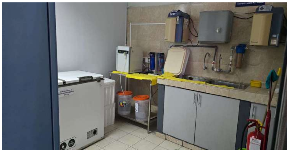
ZONA DE LAVADO – CUENTA CON SISTEMA DE AGUA ULTRAPURA
