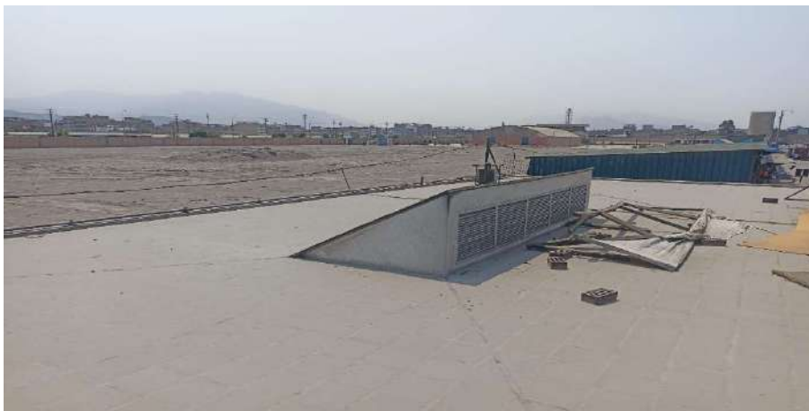
TECHO CON LADRILLO PASTELERO
